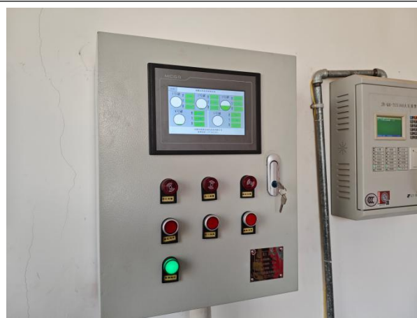
储罐远传联锁监控系统
