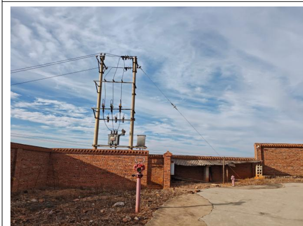
罐区西北侧变压器
